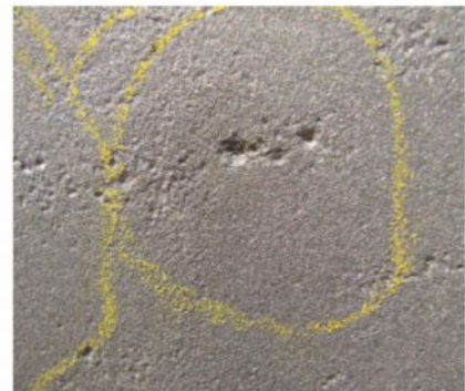
Язвенная коррозия, потеря металла - 22%. Обнаружена бесконтактным методом на подземном трубопроводе
