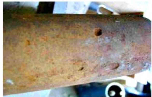
Участок язвенной коррозии, обнаруженный бесконтактным методом на подземном трубопроводе
