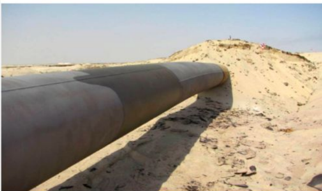
Нарушение геометрии подземной трубы, вызвавшее напряженно-деформированное состояние закритического уровня
