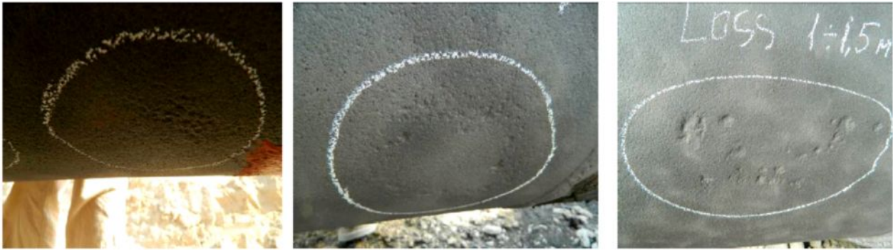
Участки язвенной коррозии, обнаруженные бесконтактным методом на подземном трубопроводе, глубина залегания - 4 м
